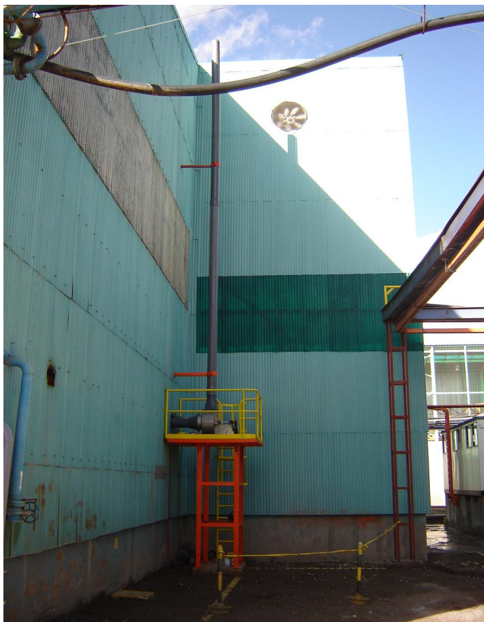
Fotografía N° XVII: Extractor de gases de la planta de procesos.
