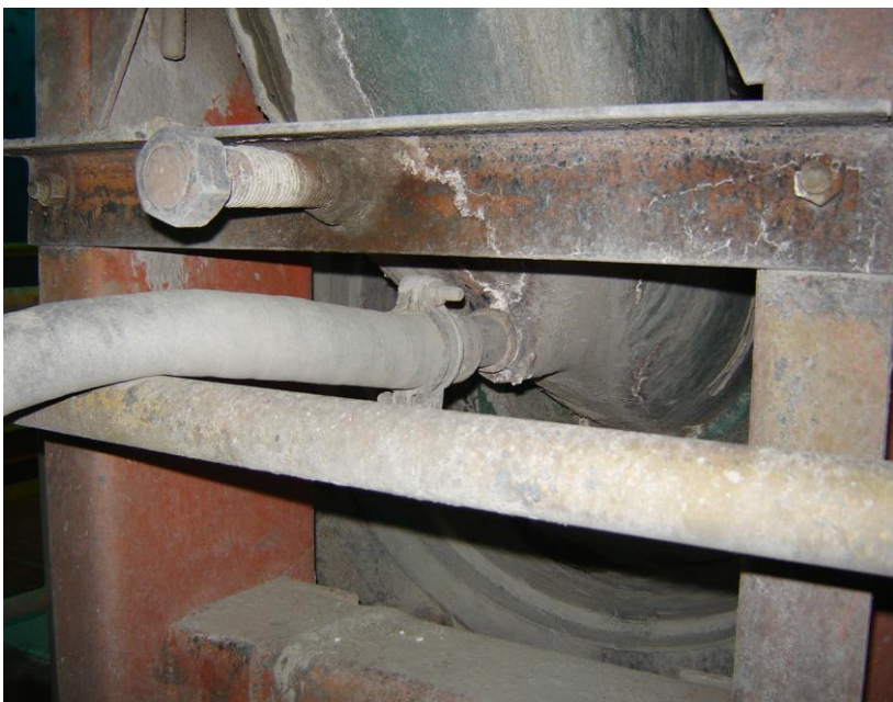
Fotografía VII: Ingreso de la solución de NaCN a las operaciones.
