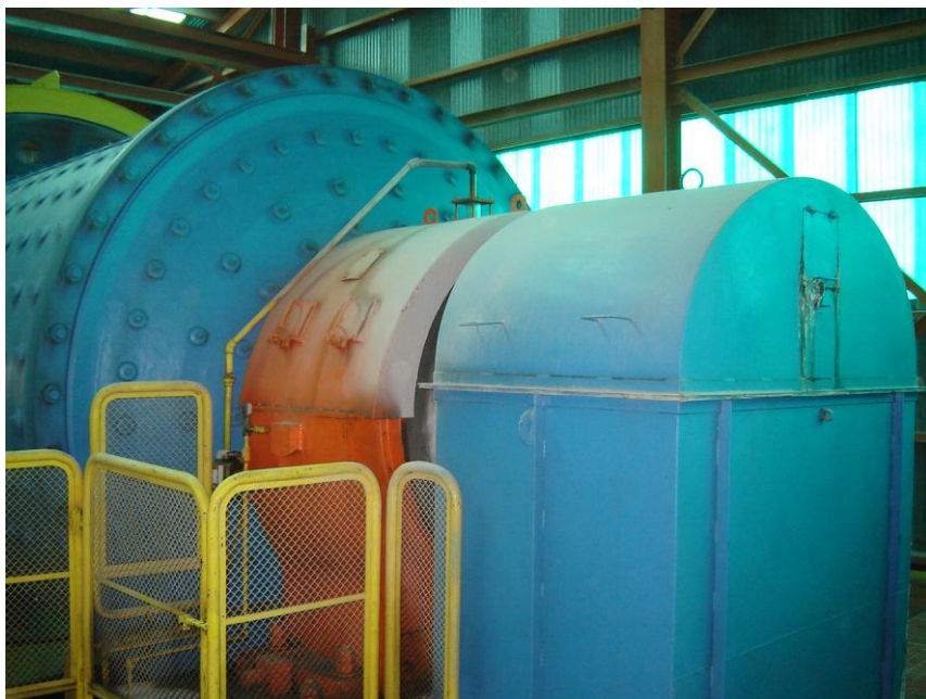
Fotografía XI: Molino dominion de bolas 12"x16" cubierto para favorecer al sistema de extracción de HCN
