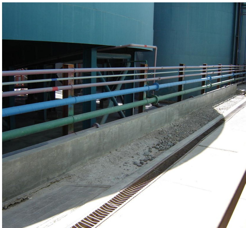
Fotografía VI: Tuberías de distribución con los colores de identificación de sustancias para la operación.
