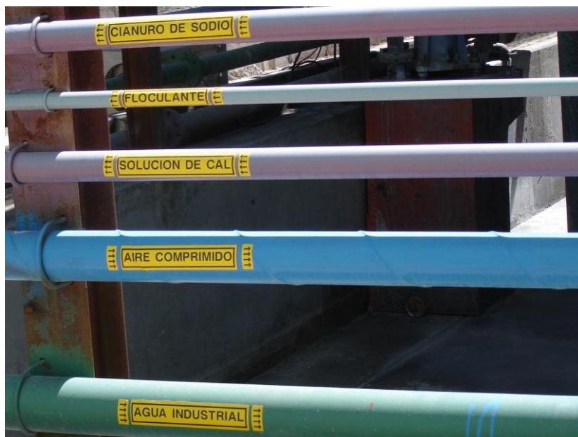
Fotografía V: Tuberías de soluciones y aire para las operaciones.
