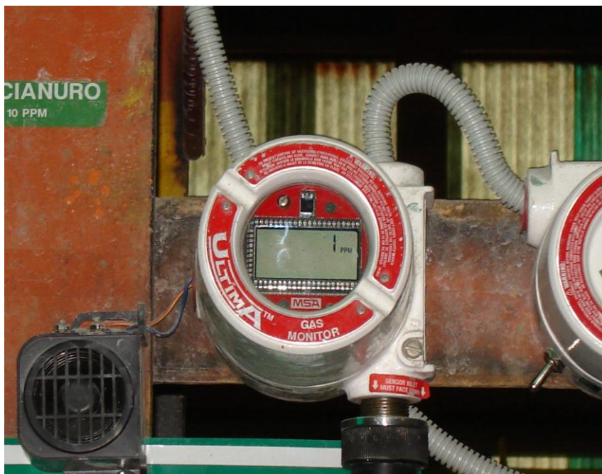
Fotografía N° XV: medidor estacionario de HCN en la sección de molienda.
