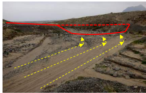
Foto 1- Rotura del dique por causa de desembalse, ubicado en la quebrada San Idelfonso.
