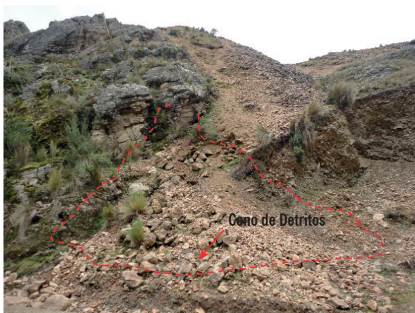
Figura N° 3. Caídas de rocas en sectores críticos de la carretera, formando conos de acumulación al pie del talud.
