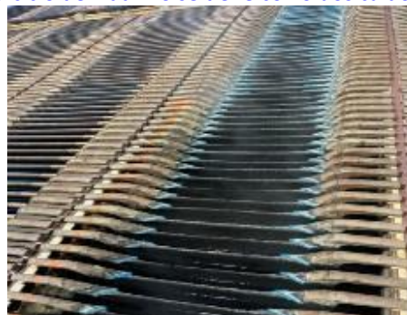
Fig. 20. Vista de los ánodos corroídos en celdas al final de su ciclo de vida. No se tiene corroídos caídos
