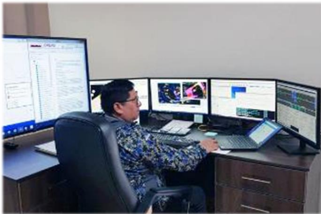
Imagen 10: Estación de despacho instalada y Operativa
