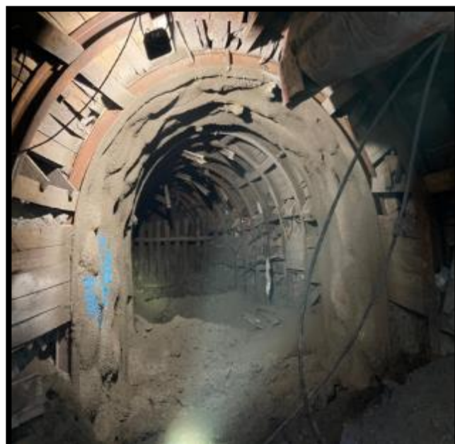
[Figura 12].- Arco Peruano instalado en tajo de producción.
