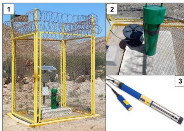
Fig. 02: Infraestructura de monitoreo hidrogeológico de calidad de agua subterránea en un piezómetro. La instrumentación automatizada consiste en: (1) Datalogger y sistema de comunicación por telemetría satelital instalada junto al piezómetro debidamente estandarizado y alimentado por un panel solar. (2) Sensor multiparámetro sumergido en el piezómetro de tubería abierta para el registro continuo de datos. (3) Detalle de sensor multiparámetro con capacidad de lectura de pH, conductividad eléctrica, nivel de agua y temperatura (SMCV, 2022).
