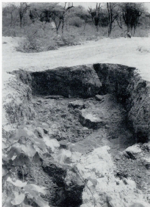
2. — Attaque par ravinement d'une piste dans les collines argileuses ; les eaux s'infiltrèrent sous la piste ; soutirage suivi d'éboulements.
