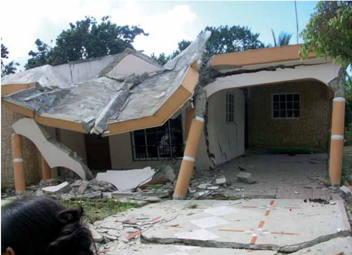
Figura 11. Daños en viviendas por movimientos del terreno. Deslizamiento en Carlos Díaz, región de Tamboril, República Dominicana, febrero de 2009 (foto cedida por Santiago Muñoz, SGN, República Dominicana).
