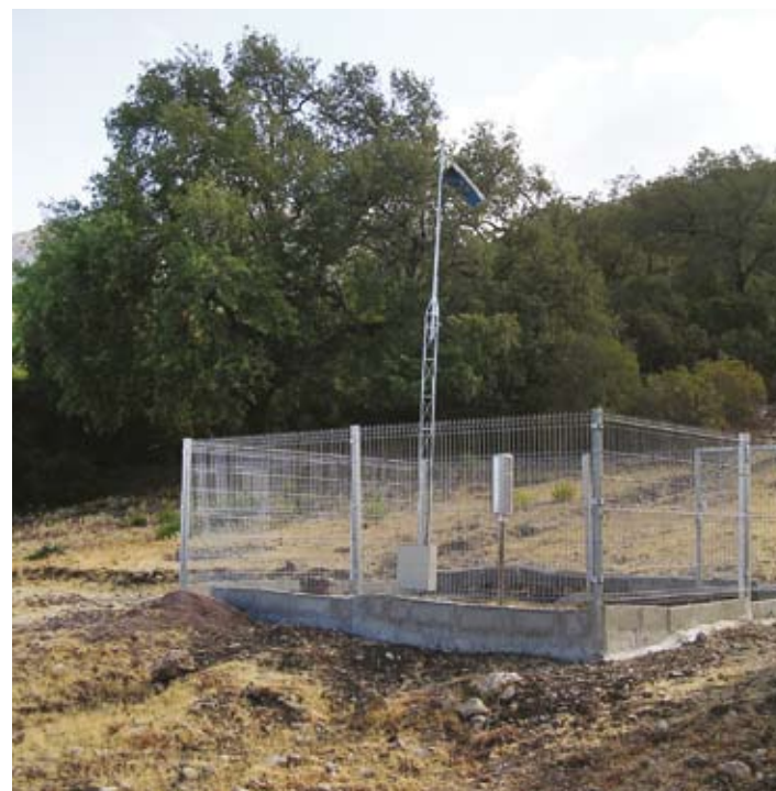
Estación automática de control pluviométrico y nivel de un sondeo
