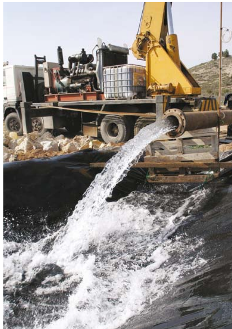
Equipo de ensayo de bombeo
