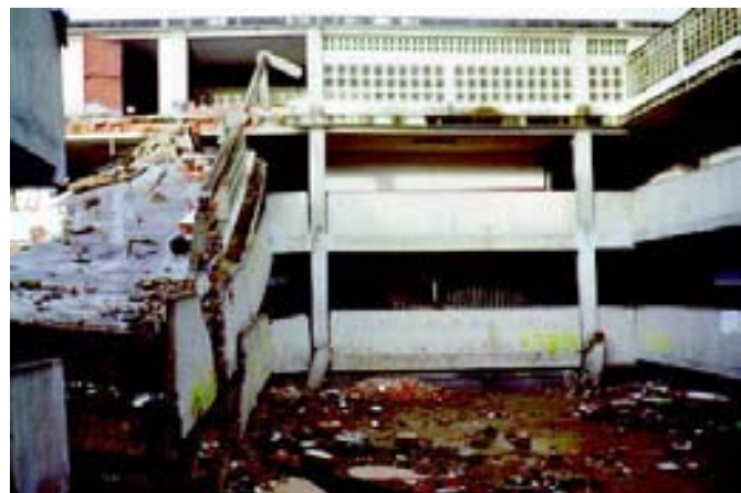
Foto 41. Escuela de Pedagogía. Daño casi total, 33 víctimas fallecidas.
