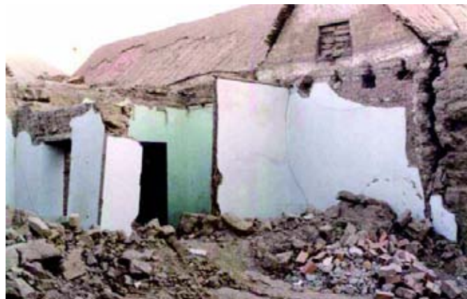
Figura 46. Destrucción de viviendas en Tacna.
