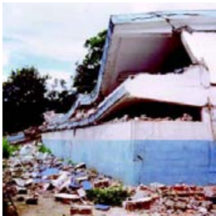
Foto 40. Liceo Reinaldo Martínez C. Daño parcial, 35 víctimas fallecidas.
