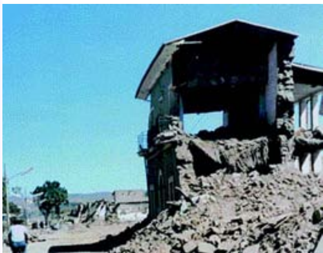
Figura 47. Casas destruidas en Aiquile.
