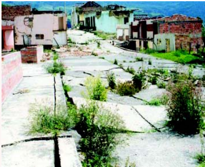
Figura 24. Agrietamientos en pisos y muros en San Cayetano, Colombia.
