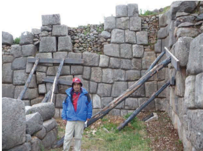
Foto 1. Muro con separación de juntas por presión lateral, y pandeamiento (Enero, 2009).
