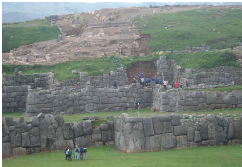
Foto 3. Muro colapsado. Nótese arriba los trabajos de excavación arqueológica. Fotos mirando al sur
