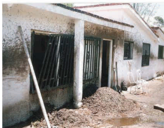
Lamina N° 2: Vivienda afectada durante el desastre del 8 de Diciembre de 2006, observar las marcas que dejó el alud de suelo y granizo en las paredes.
