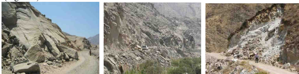
Figura 3: Ejemplos de movimientos en masa detonados por el sismo que afectaron tramos de las carreteras de penetración a la sierra; nótese principalmente caída de rocas y derrumbes.
