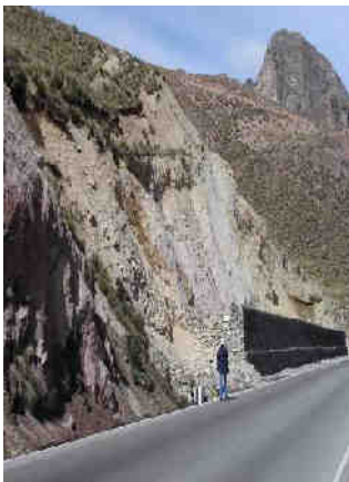
Foto 3. Derrumbe en Casanalca
