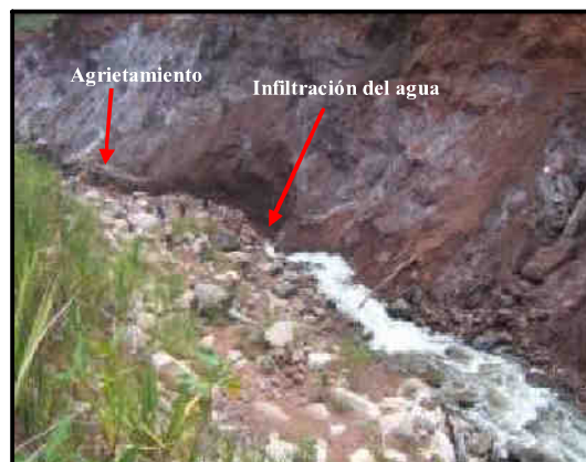
Foto 2.- Vista panorámica del sector donde se infiltra el agua y el sector agrietado por la erosión fluvial.
