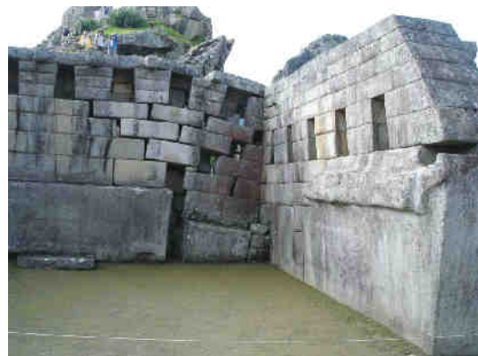
Foto 4. Asentamiento en el Templo Principal
