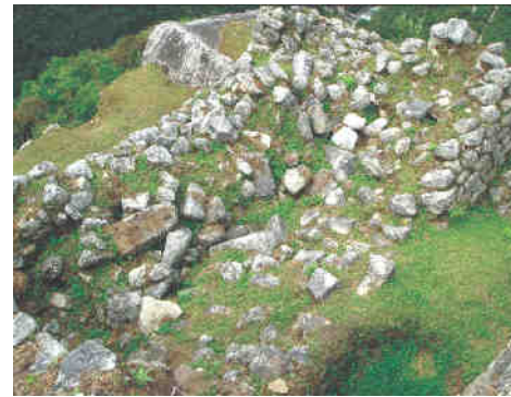
Foto 2. Proceso de sufusión que ha causado el colapso de muros en este recinto (Conjunto 13)
