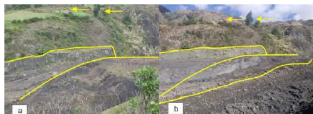
Figura 13. (a) Subsidencia de suelos, en esta imagen se muestra el nivel inicial del terreno tomada en el mes de marzo del 2013; (b) desnivel encontrado después del 13 de junio del 2013.
