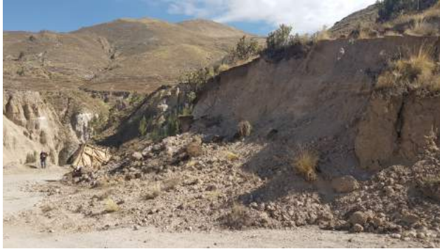
Foto 1. Deslizamiento en la carretera Coporaque - Ichupampa, margen derecha del río Colca.
