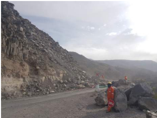
Foto 2. Caída de rocas (Derrumbe) en el tramo de la carretera Achoma-Maca. Margen izquierda del río Colca.
