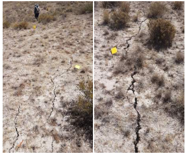
Foto 3. Grietas en el terreno generadas por el sismo del 14 de agosto, llegando a presentar abertura de hasta 10 cm.
