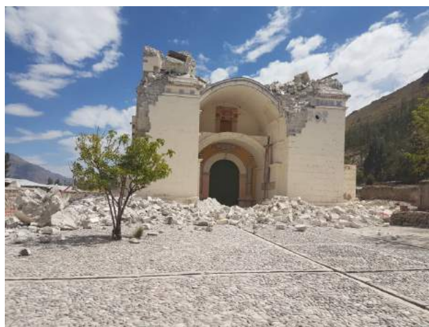
Foto 5. Daños en la iglesia destruida, los campanarios de la iglesia colapsados por efectos del movimiento sísmico.
