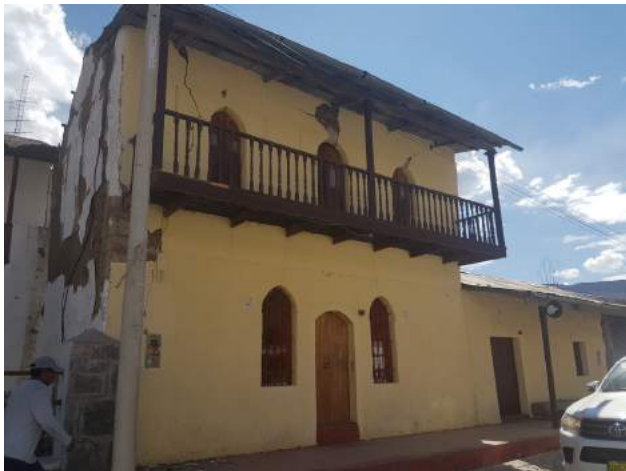
Foto 7. Vivienda afectada, los muros están agrietados por efecto de la amplificación de ondas sísmicas, el suelo y el tipo de material, es considerada una vivienda inhabitable.
