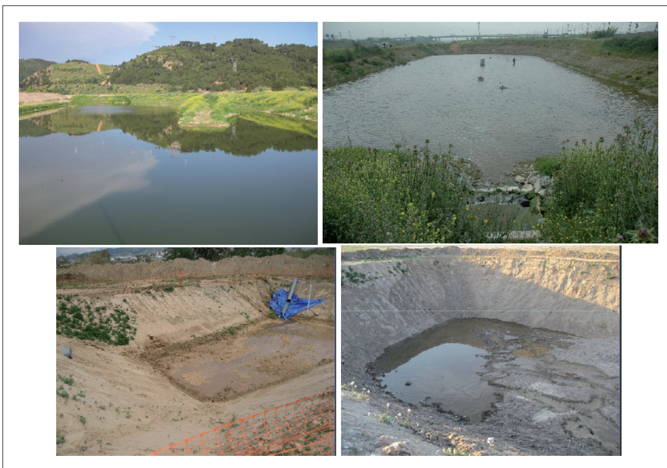
Figura 5. Balsas de recarga artificial en fase de construcción en el Valle Bajo del Llobregat y. Se muestran las balsas de Can Albareda (arriba, izq.), las de Sant Vicenç (arriba der.) y las de Sta. Coloma (abajo). El volumen total de recarga se estima que será de 6 a 10 hm 3 /año Figure 5. Recharge ponds at the Llobregat Valley. The ponds of Can Albareda are shown (above, left), Sant Vicenç (above right.) and Sta. Coloma (down). The total infiltration volume will be from 6 to 10 hm 3 /year
