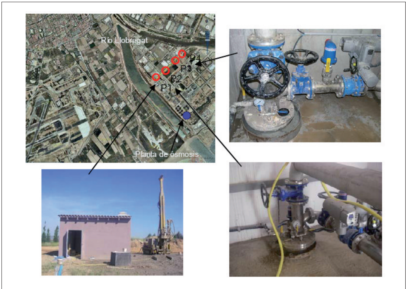
Figura 9. Detalle de los pozos de inyección de la primera fase de la barrera hidráulica. Los pozos están equipados con controladores automáticos de caudal, sondas de nivel y electrobombas para la limpieza Figure 9. Injection wells of the pilot phase of the hydraulic barrier. Wells are equipped with automatic controllers of flow, level sensors and electrical pumps for their cleaning
