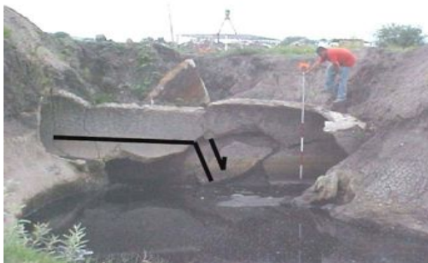
Figura 3.13 Fallamiento Venegas flanco oriente en la zona de Santa María Magdalena
