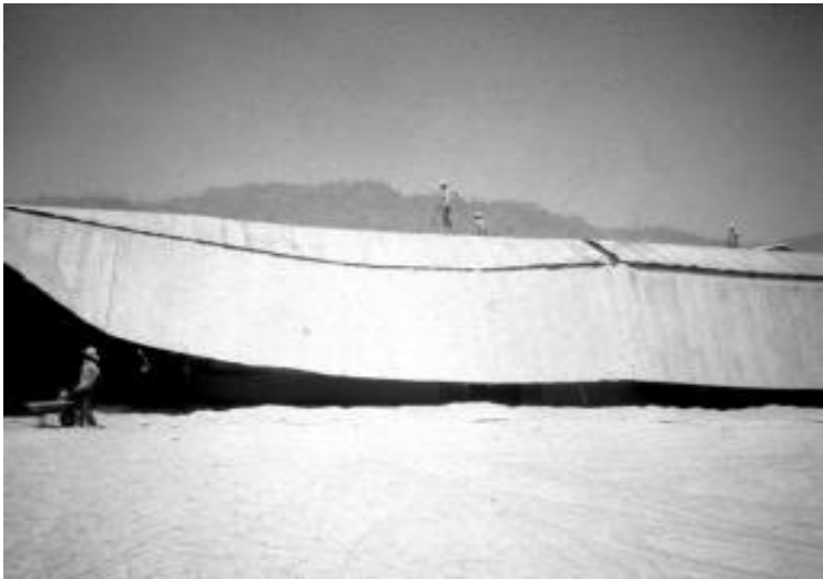
Fig. 26. El peso de la ceniza puede producir el colapso de instalaciones inadecuadamente diseñadas. La foto muestra el techo caído de la terminal camionera de Pichucalco, a unos 20 km del volcán El Chichón, que cayó por efecto de una acumulación relativamente pequeña de ceniza.
