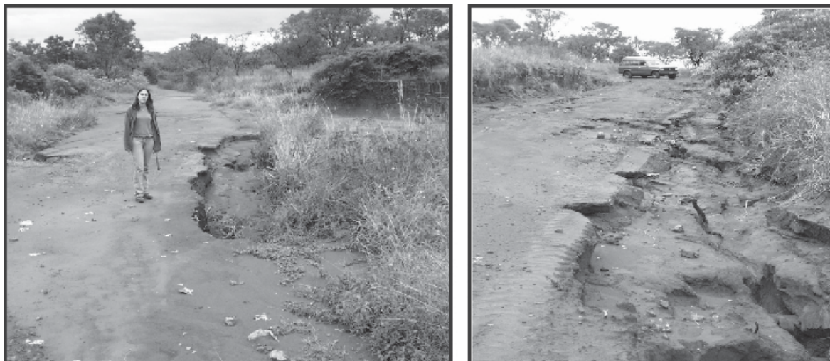
Figura 50. Cunetas y carpetas de rodamiento erosionadas.
