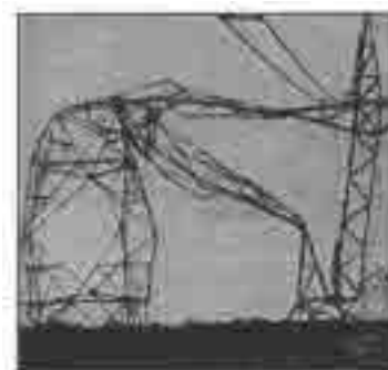
Líneas de transmisión caídas entre Sudáfrica y Maputo después de la tormenta ciclónica del 26 de marzo e 1985.
